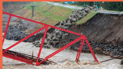
水害で被害を受けた千曲川の様子
