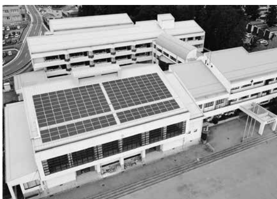
▲高瀬中学校に設置された太陽光パネル
