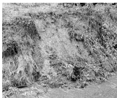
▲会染滝沢お宮下 土砂崩落
