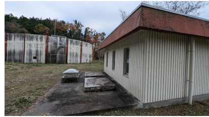
中区第2配水池（中島・半在家）
