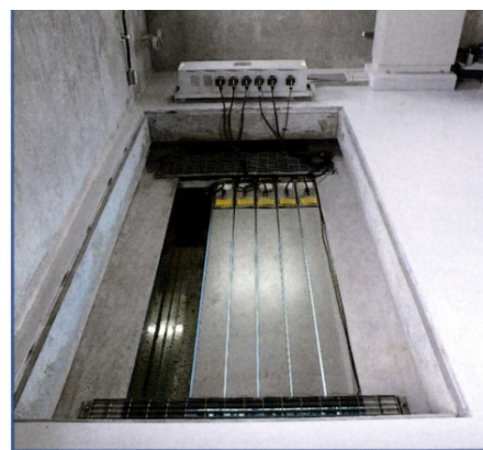
紫外線消毒装置（高瀬浄水園）
