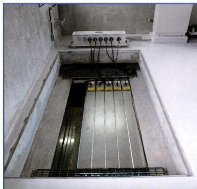
紫外線消毒装置（高瀬浄水園）
