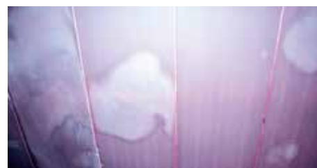
役場庁舎当直室天井の雨漏り
