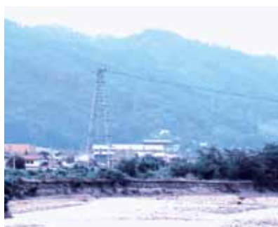
高瀬川堤防危険か所 (高瀬川大橋から豊町堤防を望む)
