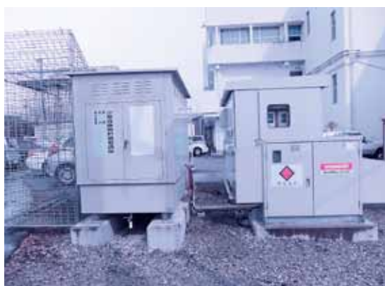
庁舎の非常電源装置
