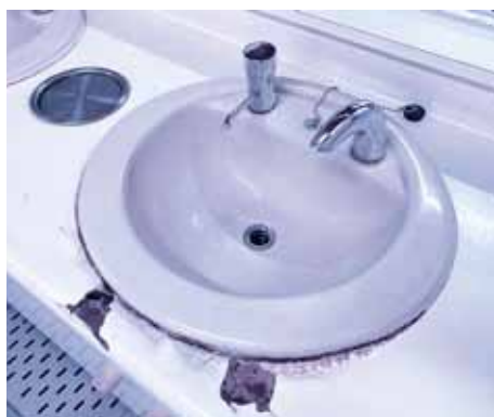
痛みが激しいトイレの水栓 (ハーブセンター)
