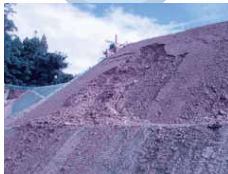
豪雨により崩れたブドウ畑の工事現場
