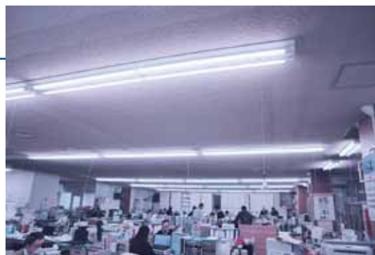
公共施設電気料の見直し
