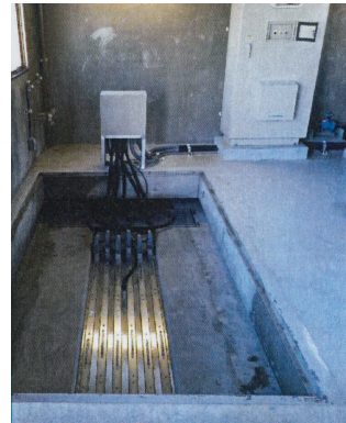
紫外線消毒装置（高瀬浄水園）
